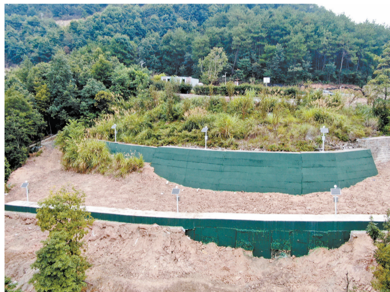
盐堰路边坡预警系统。
