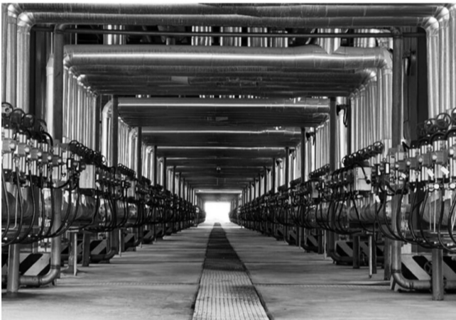
蓝科锂业提取锂元素的过滤塔
