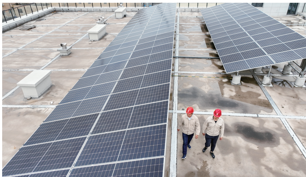
图为工作人员正在检查楼宇智能微电网设备。盛义摄
